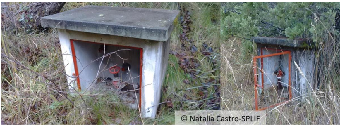
Figura 15. Estado actual de las bocas de incendios existentes en la Isla.
